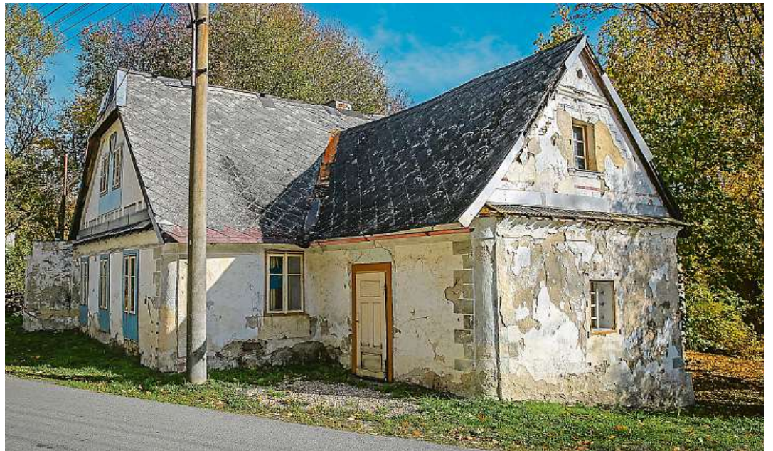
Původní stav Nejhorší na mlýně byla střecha. Dům byl vlhký, protože do něj delší dobu zatékalo. Ale podle statika měl překvapivě dobrou konstrukci. Foto: David Peltán, MAFRA
